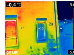
Ook meting vanaf buitenzijde is te zien dat het triple glas zijn werk doet.
